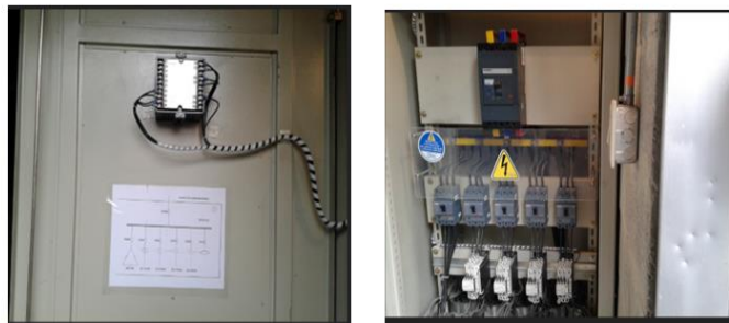
Foto 5 - Tableros baja tensión
