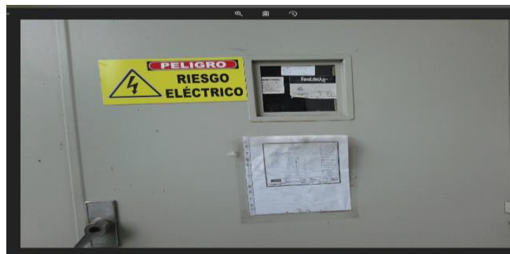
Foto 3 - Puerta cortafuego-Subestación eléctrica
