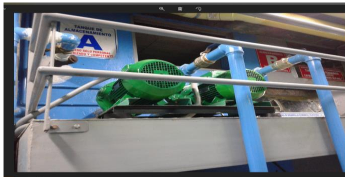
Foto 4 - Bomba aguas limpias
