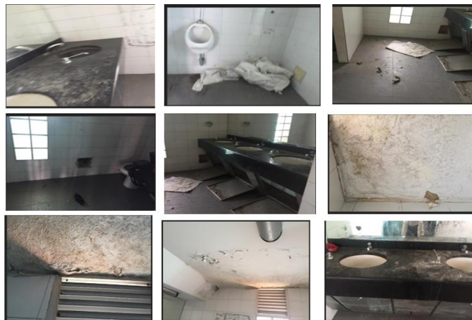
Foto 1 Baños Plaza de eventos No. 2
